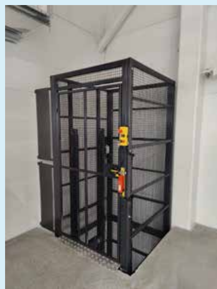
Lattian läpi kulkeva tavarahissi
